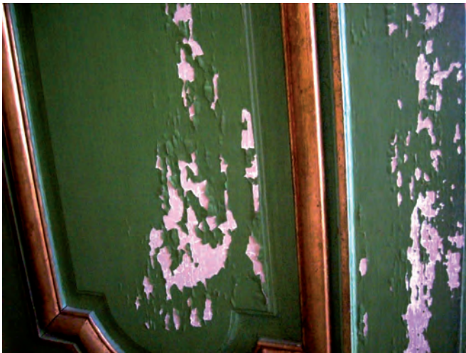
Abb. 6. Materialschäden an der historischen Ausstattung durch falsches Heizen – hier Malschichtablösung von chinesisier Boiserie / Holzvertäfelung. Nicht nur der Verzicht auf winterliche Temperierung, sondern auch der Heizungsbetrieb mit Nachtabsenkung und Konvektionssystem beanspruchen historische Oberflächen und Bauteile durch extrem belastende Klimaschwankungen (Feuchte, Temperatur, Luftbewegung, Verstaubung). Mit einer stetig betriebenen Strahlungsheizung lassen sich solche Schadensbilder weitgehend vermeiden und die natürliche Materialalterung verlangsamen.
