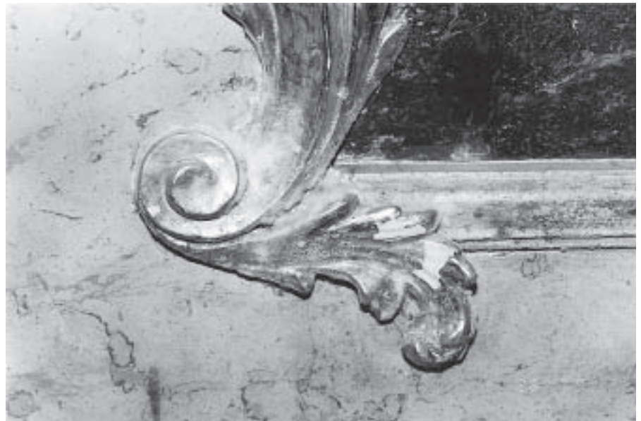
Abb. 4. Verschimmelung des Akanthus eines Seitenaltares in der Klosterkirche Weltenburg nach einer Überschwemmung (Foto: Verf.).
